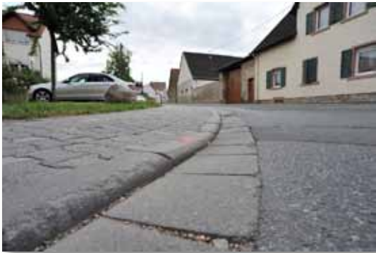
Gehweg muß saniert werden.
